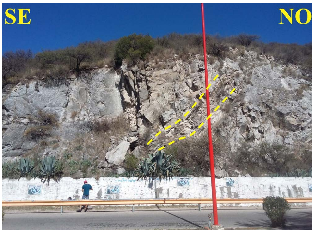
Figura 7. Vista panorámica al sudoeste de un sector del talud N° 3, donde el granito es afectado en un sector por cizalla frágil (entre líneas de color amarillo)
