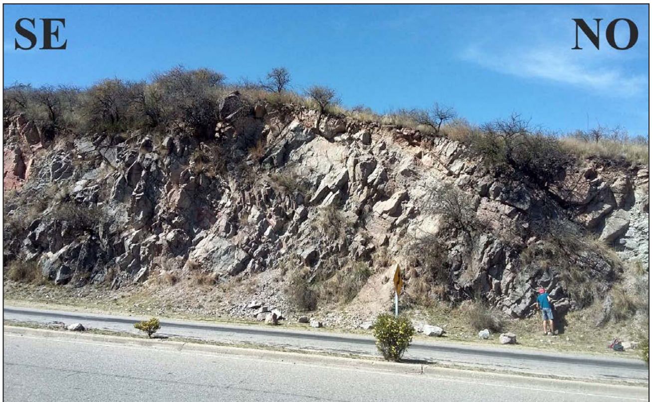
Figura 6. Vista panorámica al sudoeste de un sector del talud N° 2, afectado por cizalla frágil, que disgrega mecánicamente al granito
