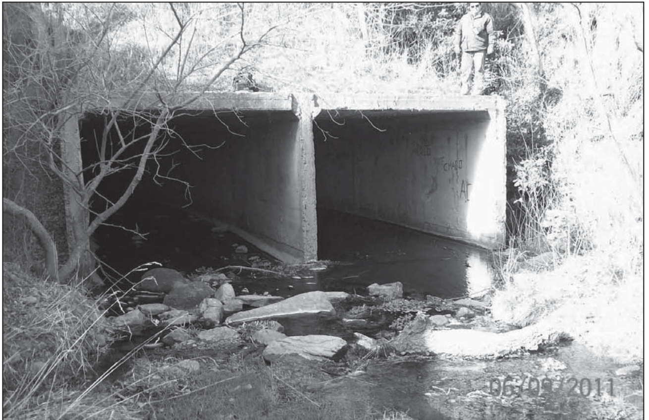
Figura 3. Vista del inicio del entubado del Arroyo Blanco, aguas arriba del eje de cierre de la futura presa.
