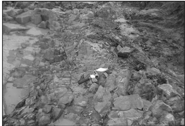
Figura 6. Área de estribo de margen derecha. Dique de rocas pegmatíticas rosadas en el plano de fundación previo a las tareas de saneamiento del contacto con rocas de composición gneissica. Se observa buena calidad geomecánica de la matriz rocosa pero con intensa presencia de fisuras, en parte rellenas de arcillas.
