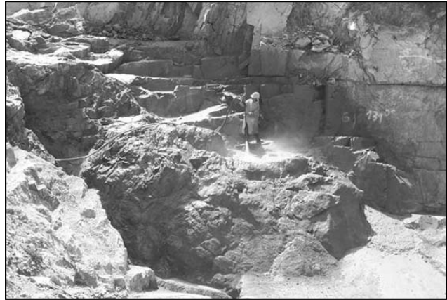
Figura 4. Limpieza de la roca de fundación mediante aire y agua a presión.
