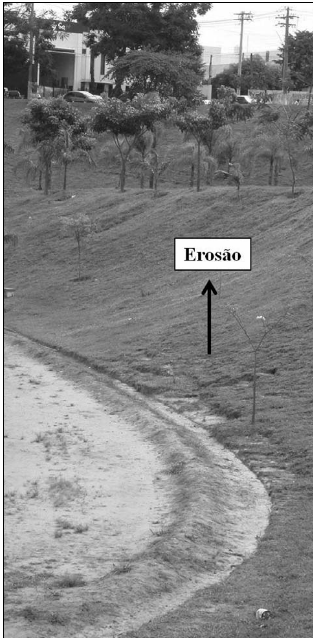
Figura 11. Sulcos erosivos em talude da Área 3.
