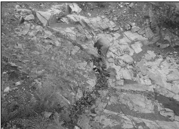
Figura 7. Sector demarcado para limpieza y calafateo de material muy fisurado con parcial presencia de arcillas plásticas rellenasdo fisuras entre progresivas 170 a 180.
