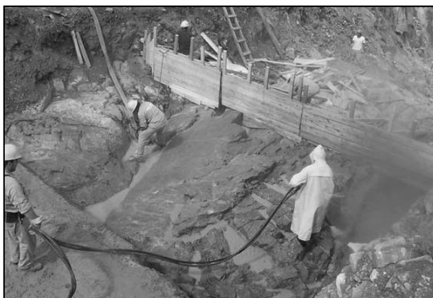
Figura 9. Vista de la fundación entre progresivas 165 y 170. Tarea de limpieza con aire y agua a presión previo al hormigonado de protección y construcción del zócalo de apoyo. Se observa dique pegmatítico en roca de caja de composición gneissica.
