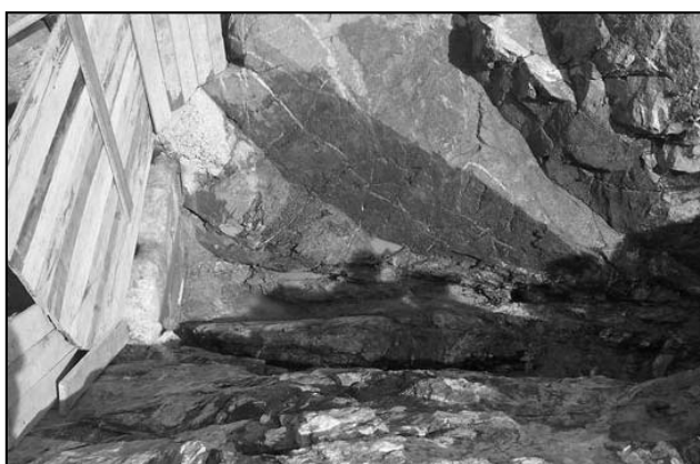
Figura 13. Sanamiento dental finalizado del contacto gneiss - pegmatita en progresivas 125 a 150m, realizado el procedimiento de lavado con aire y agua a presión previo al hormigonado de reemplazo y protección.
