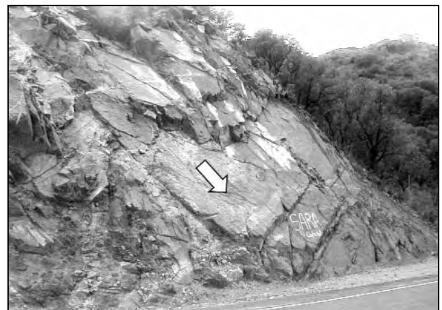
Figura 10. Talud con riesgo de deslizamientos de bloques por rotura planar
