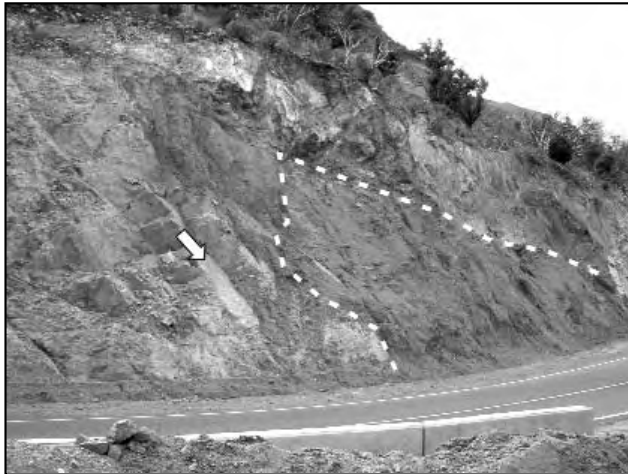
Figura 6. Vista panorámica hacia el NO de uno de los taludes. Entre las líneas punteadas se observa un sector con avanzado grado de meteorización
