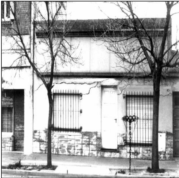
FIGURA 5: GRIETAS Y FISURA EN LAS PAREDES DE VIVIENDAS EN ING. WHITE, SOBRE LA LLANURA EMERGIDA
