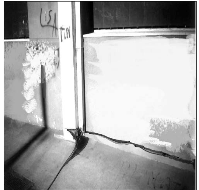
FIGURA 6: HUNDIMIENTO DEL PISO DE LA ESCUELA N° 57 UBICADA SOBRE EL ALUVIO-COLUVIO
