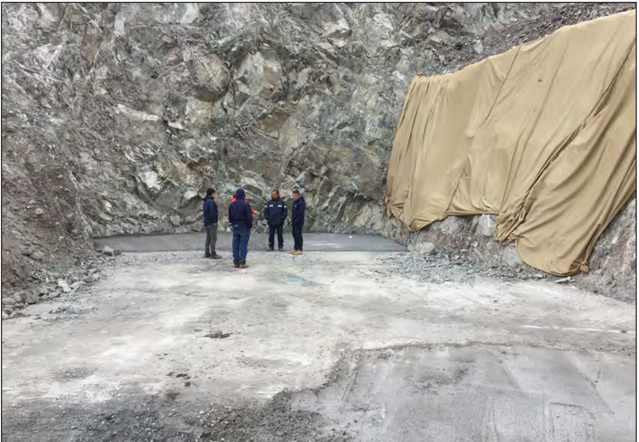
Figura 15. Vista del plano de apoyo de la cimentación cubierto con hormigón de base de asiento.
