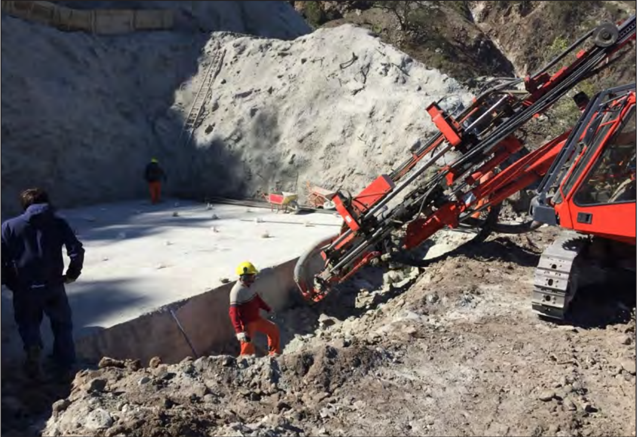
Figura 16. Vista de trabajos de anclaje inclinado en la conformación de la base de asiento del cimiento.
