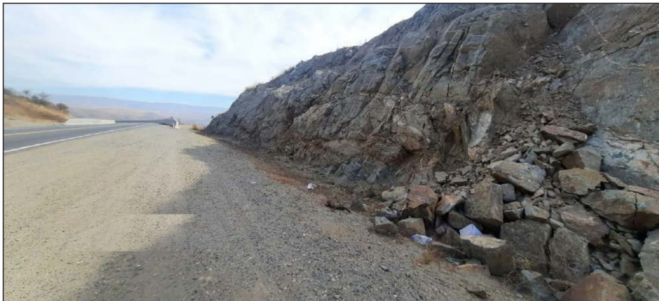
Figura 7. Talud EG17. (31°31'56" - 64°32'02") Desmoronamiento de bloques y obstrucción de cuneta. Vista hacia el Oeste.
