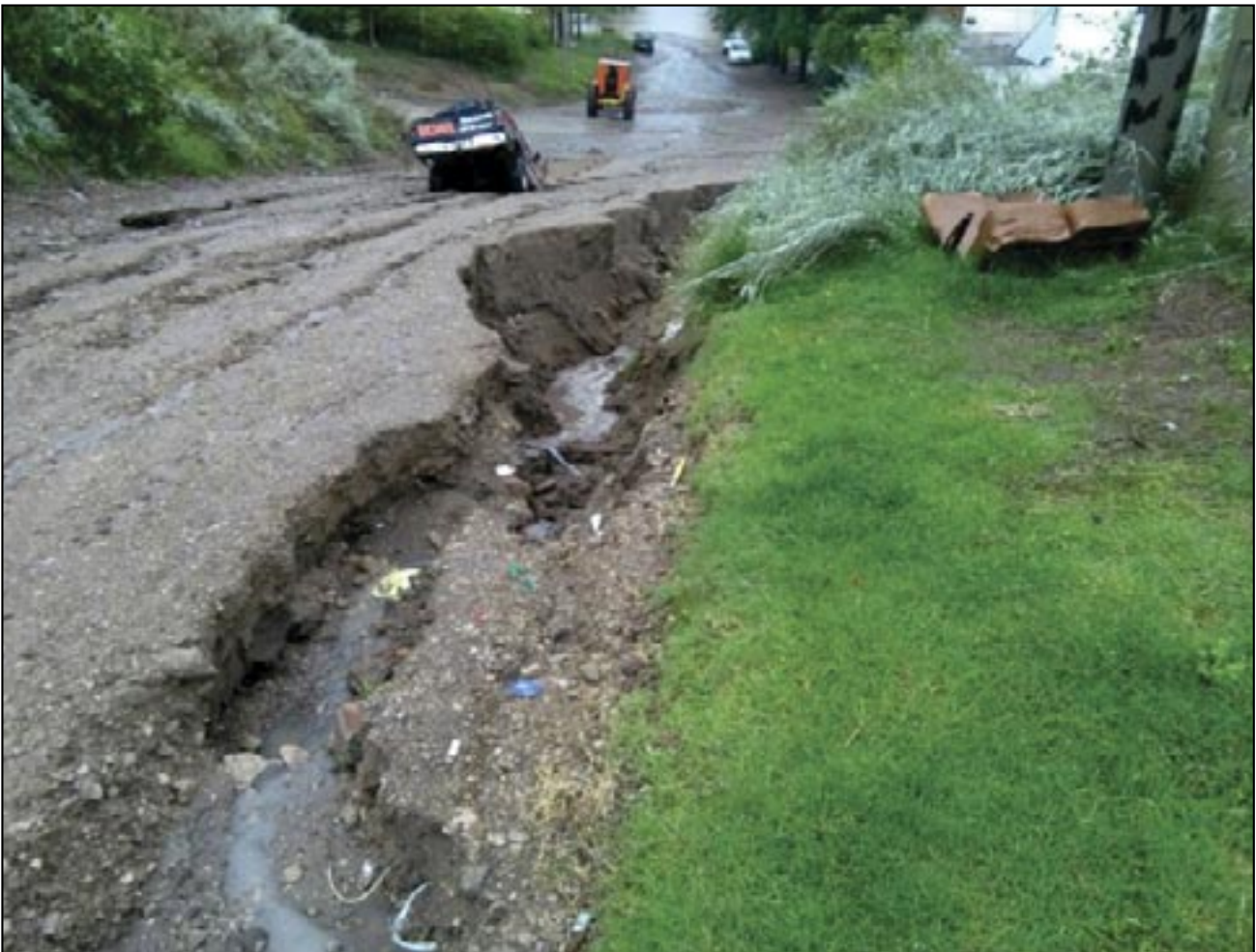
Figura 2 y 3. Inundaciones en viviendas y socavones en calles sin asfalto. Fuente: lanueva.com / Agencia Monte Hermoso. Marzo, 2017
