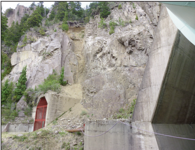
Figura 14. Detalle de la falla inferior, indicada en la Figura 13, sobre el acceso a la galería de inspección.
