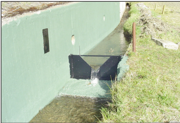
Figura 4. Detalle del Aforador 2, ubicado en el sector sur de la Capilla.
