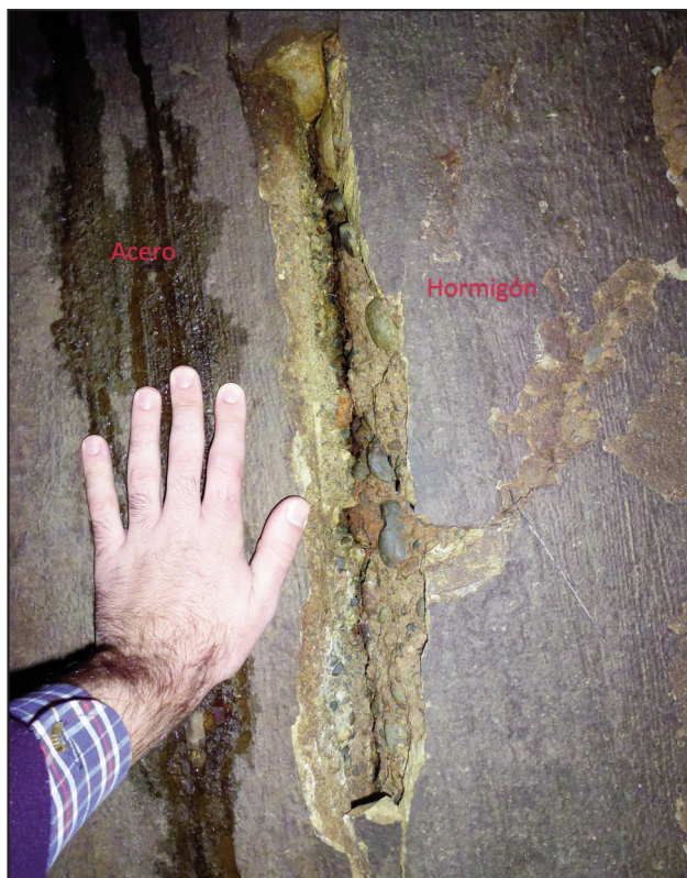
Figura 17. Detalle de la fisura localizada en el contacto hormigón-acero, en el túnel de aducción, próximo a la Boca II.
