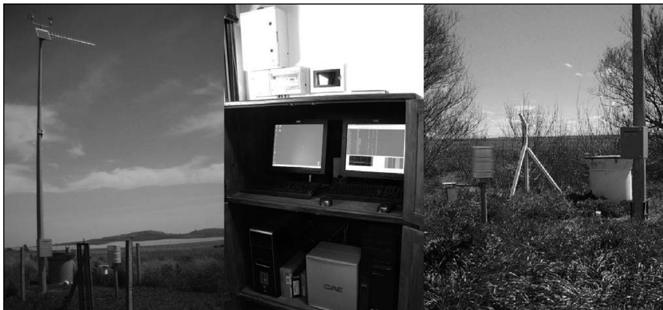
Figura 4. Estaciones telemétricas y unidad central de control de la red de alerta temprana de inundaciones de la ciudad de Azul.
