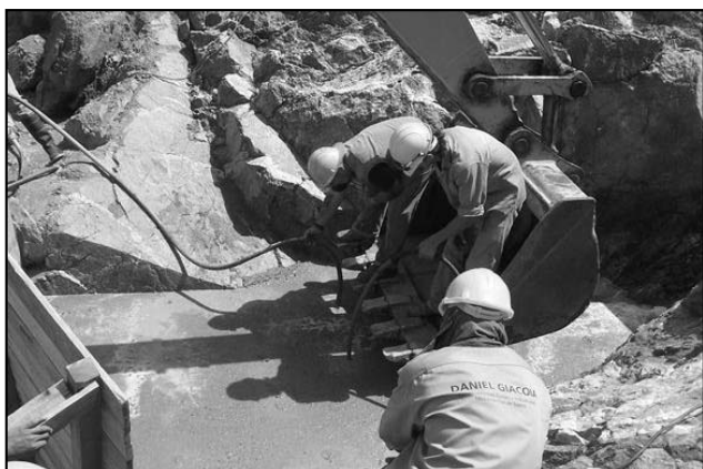
Figura 15. Saneamiento dental. Vibrado del hormigón H13 de reemplazo de la roca extraída de baja calidad geomecánica en el sector saneado.
