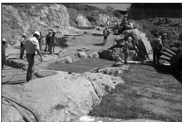
Figura 17. Vista general del saneamiento efectuado en el lateral izquierdo de la presa previo a la construcción del zócalo de apoyo u hormigón de regularización o plinto.
