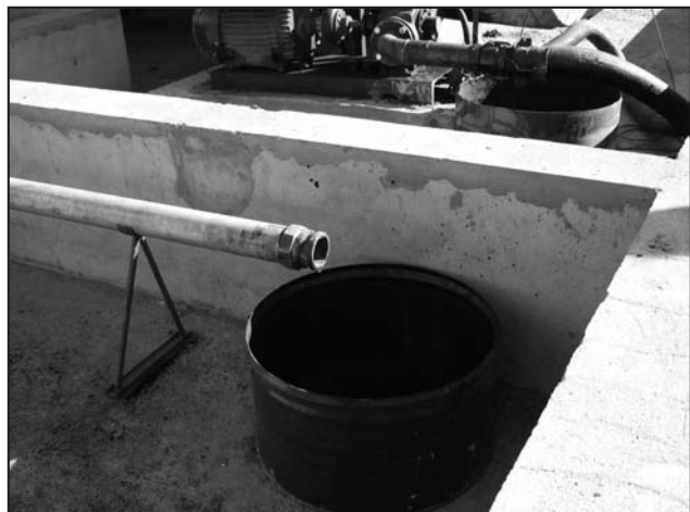
Figura 8. Bateas de contención de derrames.
