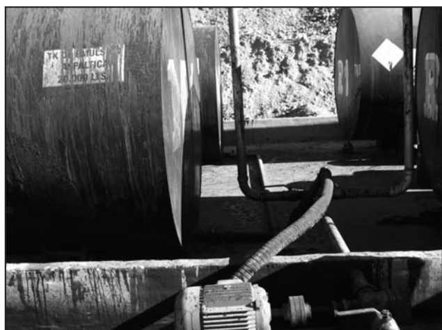
Figura 9. Instalaciones con derrames en cañería de distribución.
