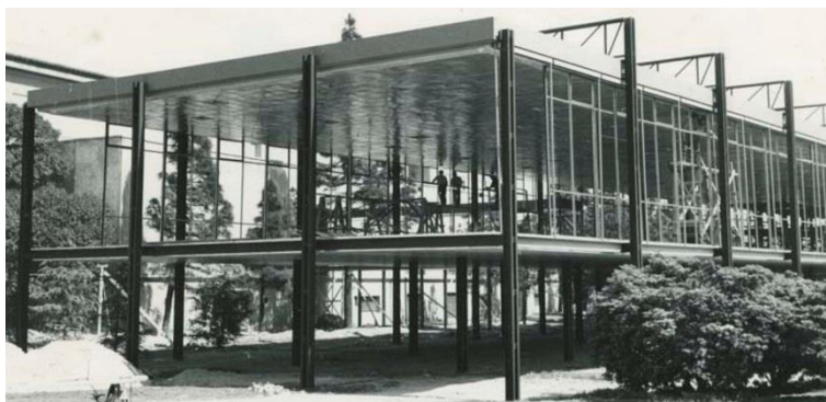
Figura 9. Montaje de la estructura y carpinterías metálicas previo a la colocación de las cortinas.
