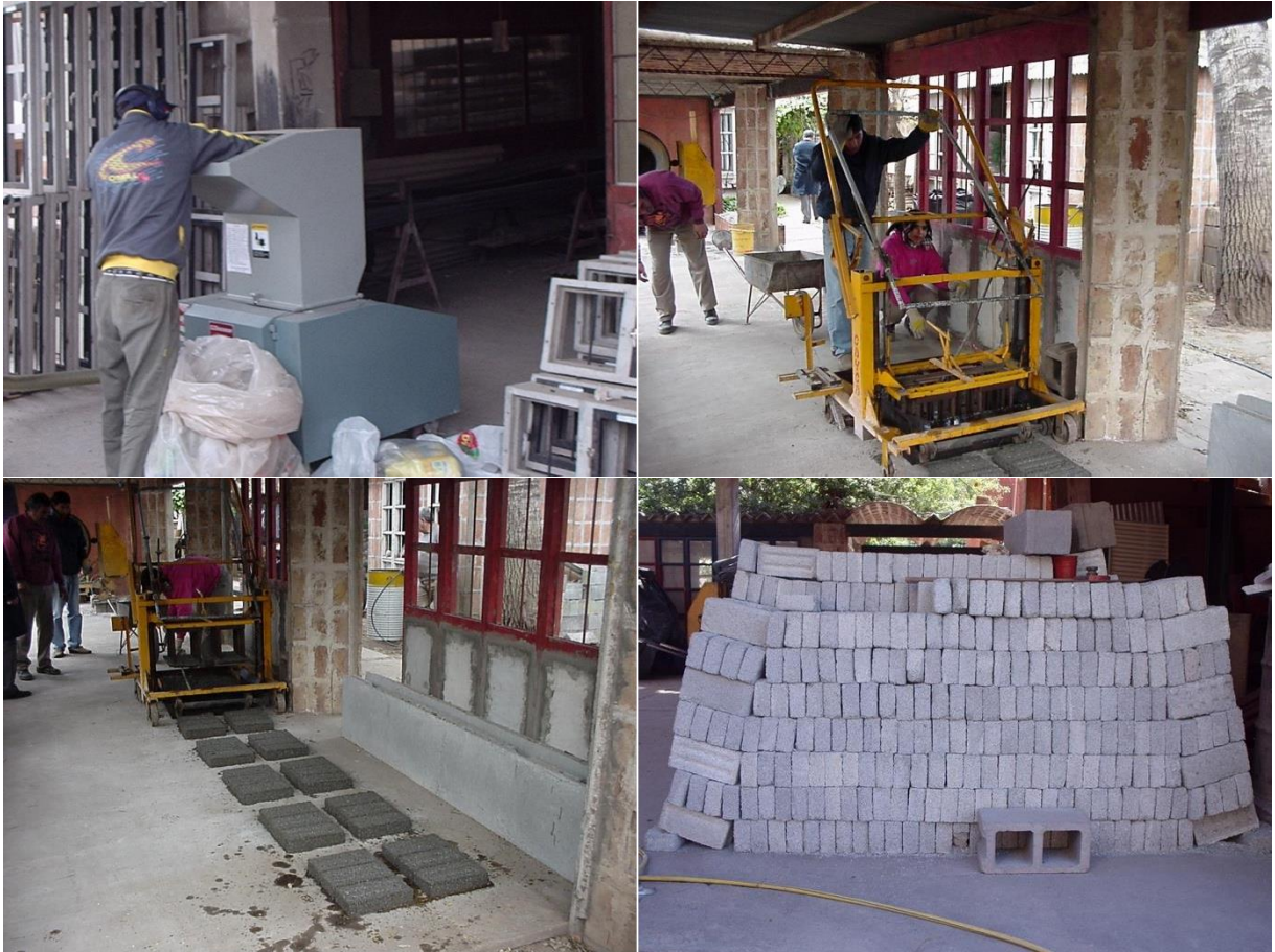
Foto 2. Proceso de fabricación de ladrillos con PET reciclado. Fuente: archivo fotográfico del CEVE.
