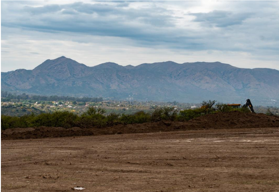
Topadoras arrasando el monte nativo cercano a la localidad de Molinari. (Foto Pablo Sigismondi)
