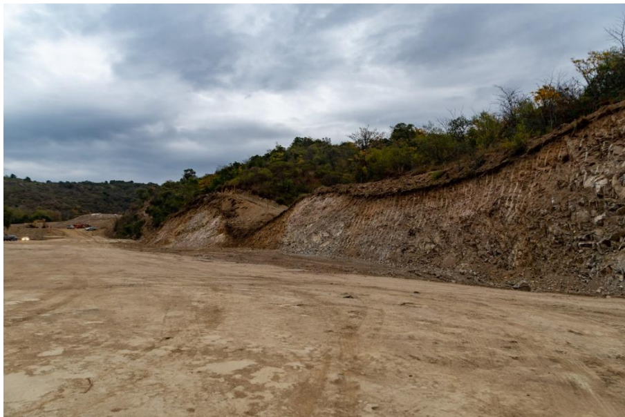
Avance de las obras de la autovía sobre la ruta provincial 5. (Foto Pablo Sigismondi)
