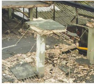
Imagen de falla por punzonado obtenida de la web
