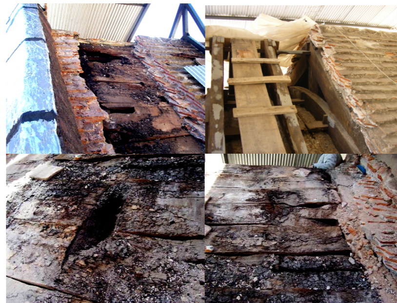
Apertura de la cubierta, daños provocados por los insectos en el entablado
