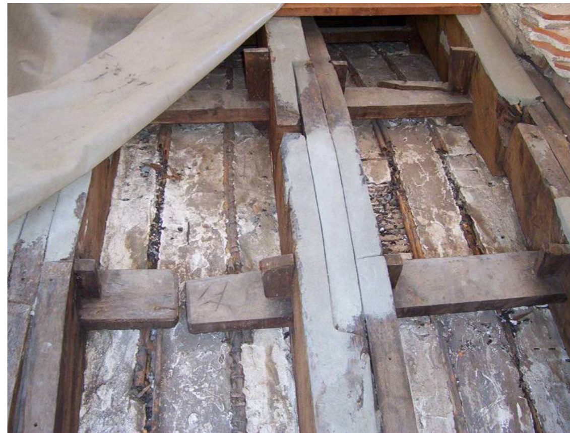
Sector de la estructura recuperado
