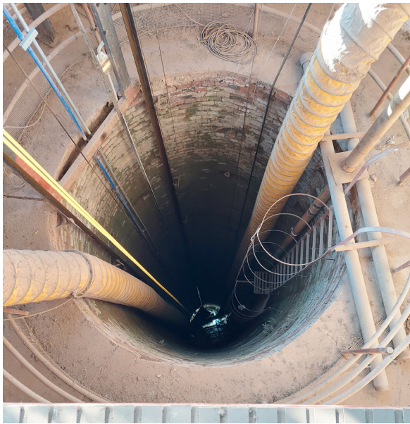
Figura 2. La instalación de apoyo ferroviaria en proceso de excavación. Diámetro: 3 m. Observar la infraestructura instalada para avanzar con la pericia forense (por ejemplo, baranda perimetral, mangas para oxigenar el interior del pozo, guías del elevador, escalera de emergencia, etc.). Registro: Archivo CAMIT, septiembre de 2022.
