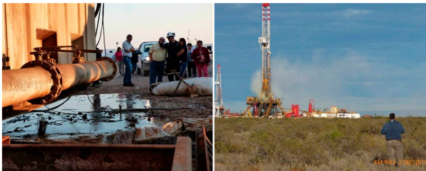
Figura 3: Derrame de petróleo crudo (izq.) y fuga de gas en instalación de perforación (der.) monitoreados por la Comunidad Campo Maripe. Fuente: Villareal & Meza Huecho, 2015.
