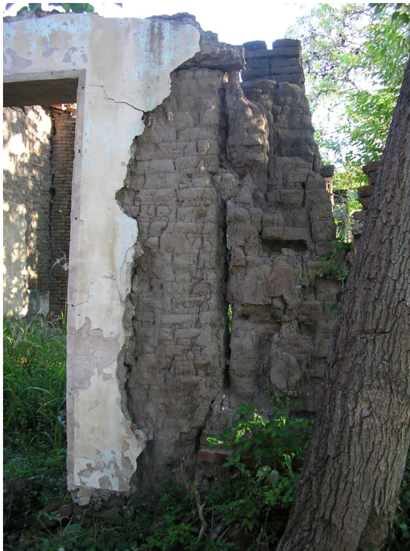
Figura 1. Estado de los muros originales de la vivienda antes del inicio de las tareas de recuperación y reconstrucción.
