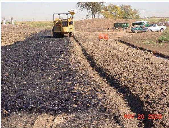
Fig. 6: Construcción del terraplén reforzado con fibras de polipropileno en el proyecto "President George Bush Turnpike" (Gregory, 2006)
