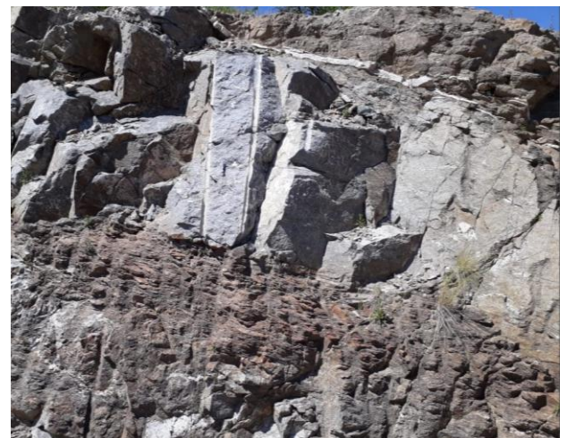
Fig. 5: Altura en la fotografía: 18 m. Talud EG 25 (31° 32.213' S – 64° 28.866' O). Factor de perturbación D diferenciado.
