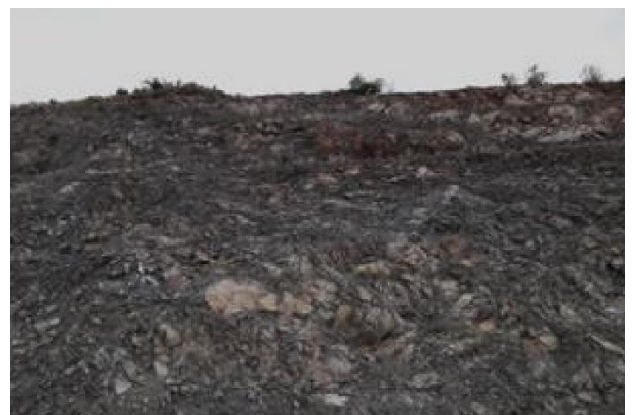
Fig. 15: Talud rocoso en zona de falla de Sierra Chica, (Coord.: -64°33'; -31°32'33") con presencia de rocas muy fracturadas y cataclasitas. Altura de talud = 8 m.
