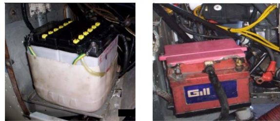
Fig. 3: “Collage” de elaboración propia extraído de la Adv. 078/DAG, de baterías. Ejemplos del rebusque criollo y la necesidad de generar proveedores certificados. Baterías no autorizadas montadas en contenedores no autorizados, o bien baterías no autorizadas camufladas en carcasas de baterías autorizadas.
