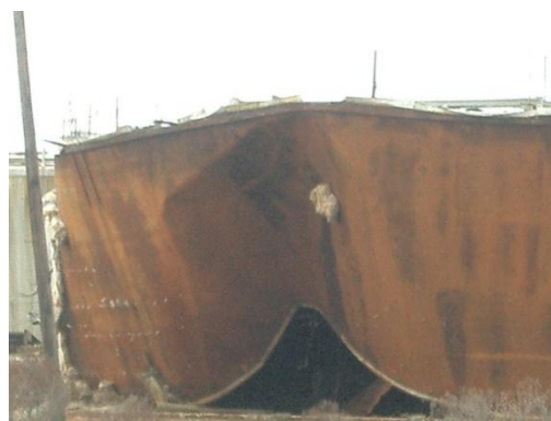
Figura 2: Falla de un tanque en una planta en Port Sulphur, Luisiana, Estados Unidos, debido a acción directa de viento durante el Huracán Katrina en 2005 (Godoy, 2007).
