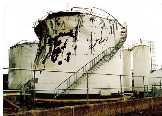
Figura 3: Falla de un tanque bajo presiones debidas a la explosión del 11 de Diciembre de 2005, Buncefield, Inglaterra. (Buncefield, 2008)
